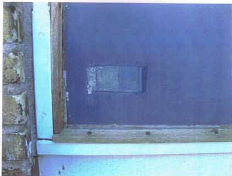
Fig. 17. Lagvis afdekning udført på vægfelt under vinduet. Afdækningen viser 6 afdækkede farvelag, hvoraf det ældste (lag 1) er en gråblå farvelag.
